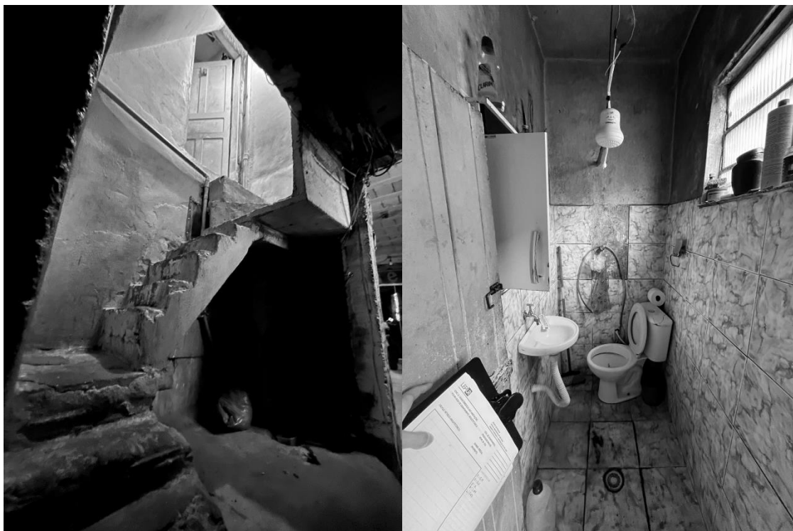
Fig. 4: Características do interior de um mesmo domicílio: ênfase para as escadas inadequadas, instalações sanitárias e elétricas precárias.
